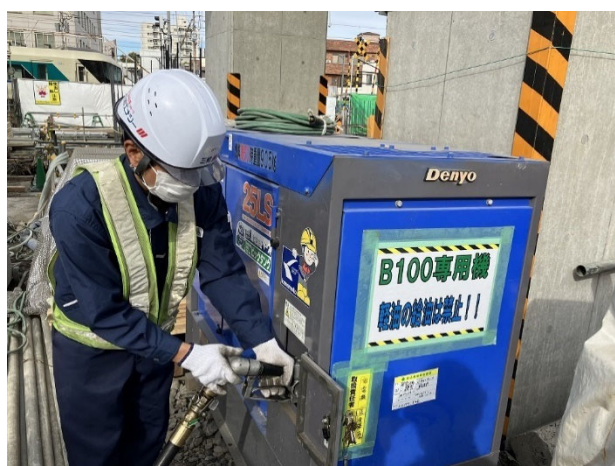
B100 専用発電機(給油の様子)
